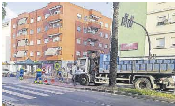
Zona afectada por el reventón de la tubería en la capital regional.
