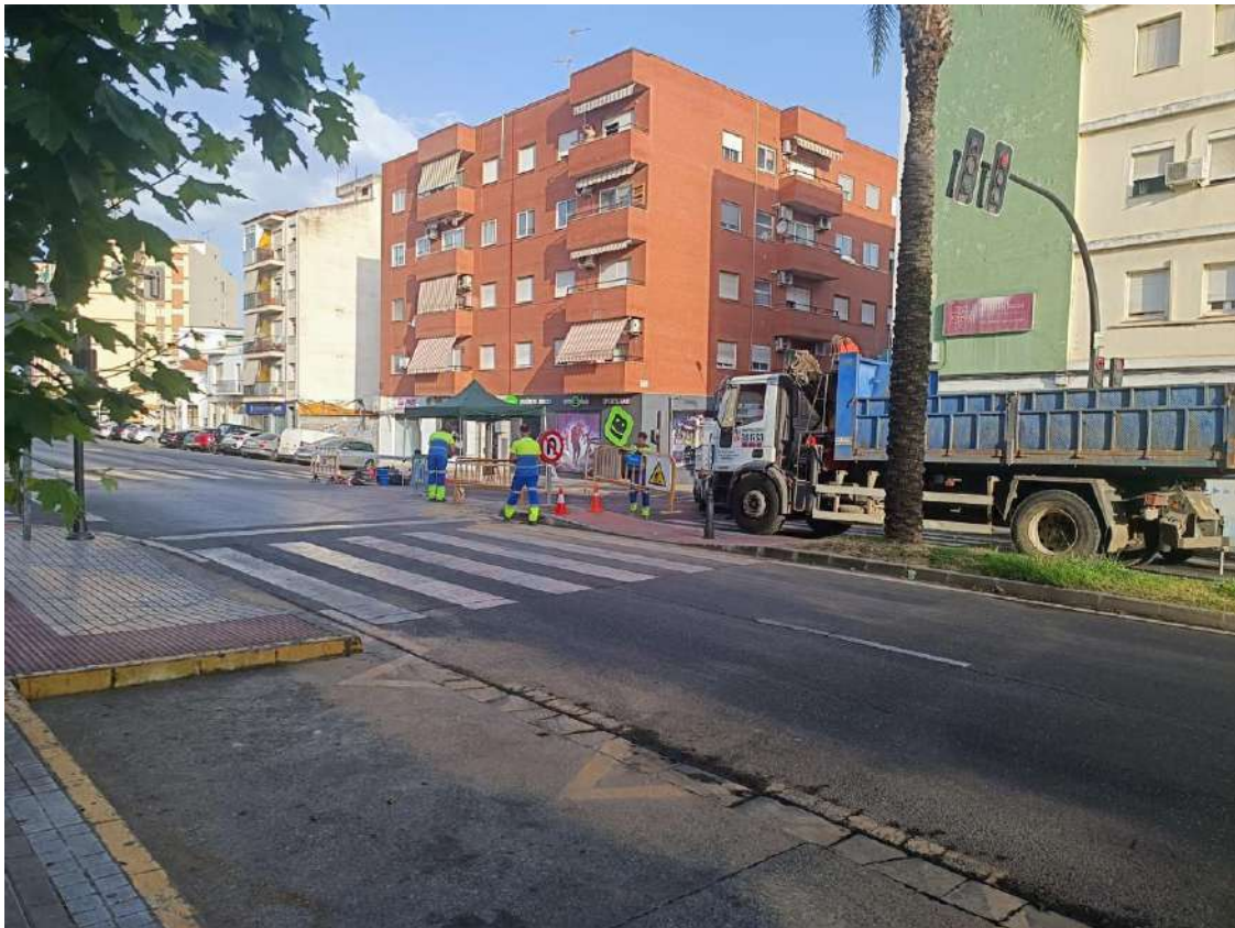
Zona afectada por el reventón de la tubería. / Cedida a El Periódico Extremadura
