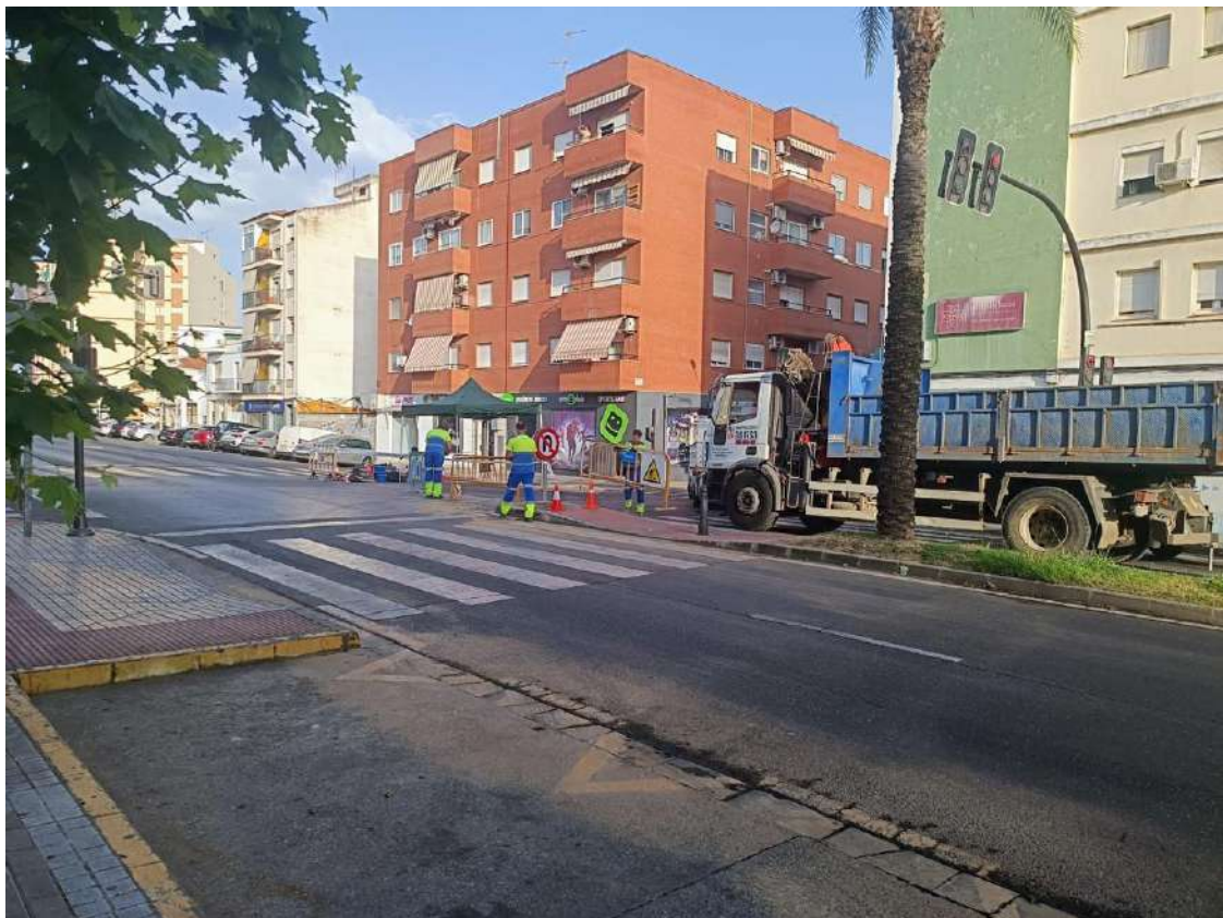
Zona afectada por el reventón de la tubería. / Cedita a El Periódico Extremadura
