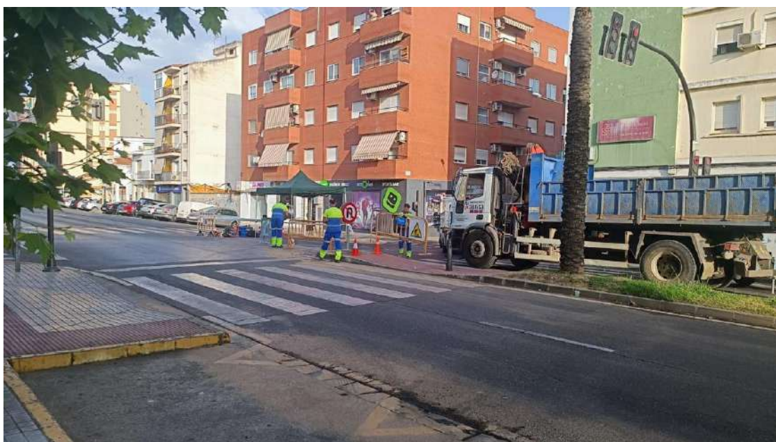
Zona afectada por el reventón de la tubería. / Cedita a El Periódico Extremadura
